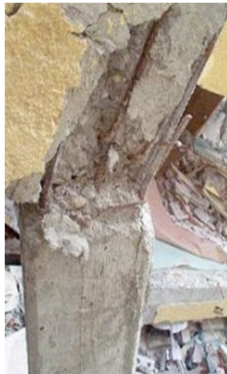
Fallo por adherencia en anclaje
