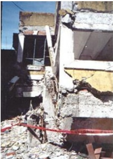
Fractura del acero, escasa ductilidad
