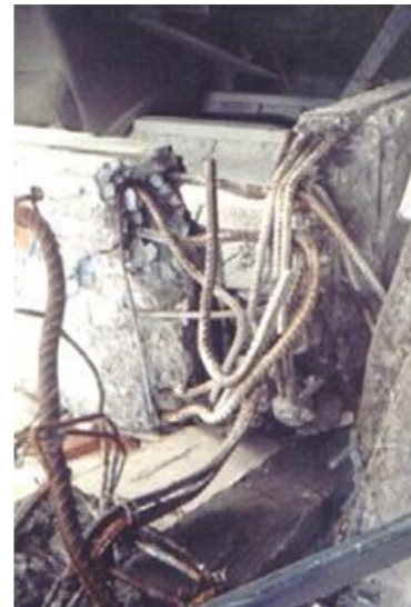
Colapso columna débil - viga fuerte
